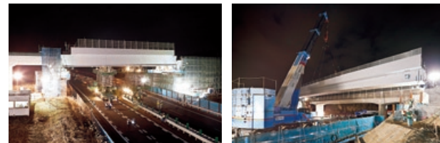
多軸式移動台車による一括架設(10号橋) 大型クレーンによる大ブロック架設(稲荷峰橋)
